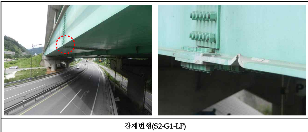
【사진 3.3.6】 강박스 거더 외부 손상현황(부산)
