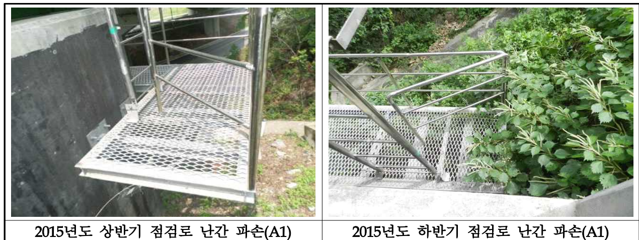
【사진 3.2.25】 점검시설 손상현황(대구)
