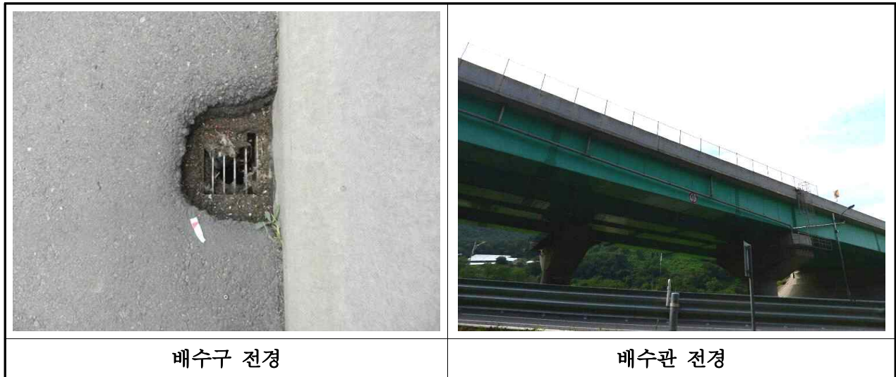
【사진 3.2.20】 배수구 및 배수관 전경(대구)
