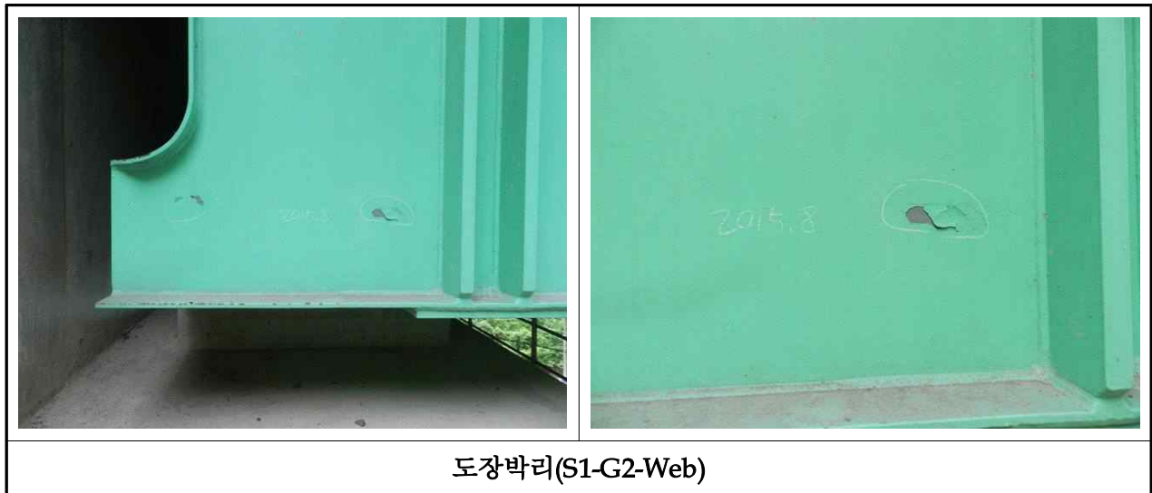
【사진 3.2.6】 강박스 거더 외부 손상현황(대구)
