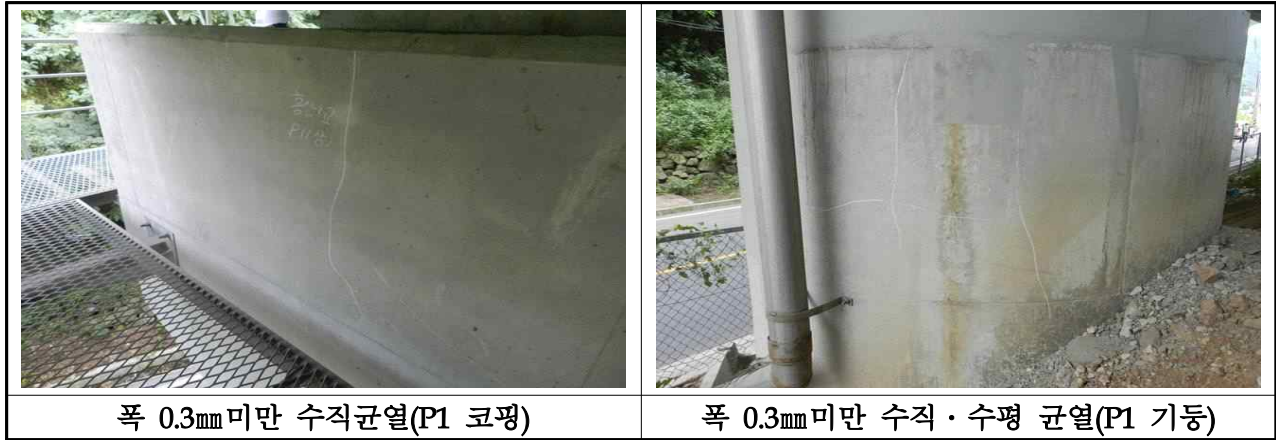
【사진 3.2.11】 교각 손상현황(대구)
