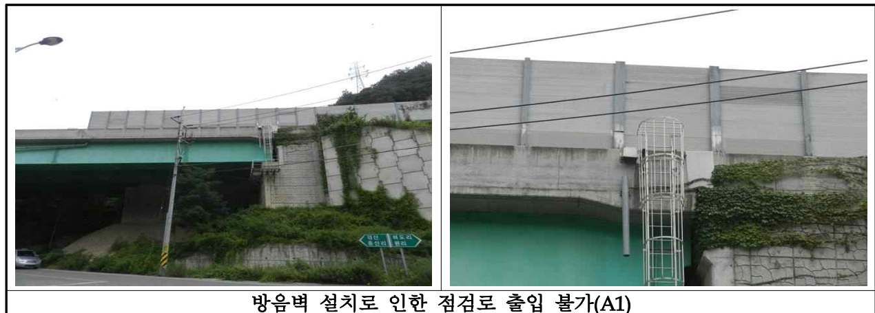
【사진 3.3.26】 점검시설 손상현황(부산)
