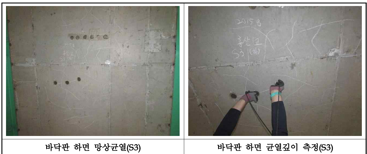
【사진 3.3.3】 망상균열부 균열깊이 측정(부산)
