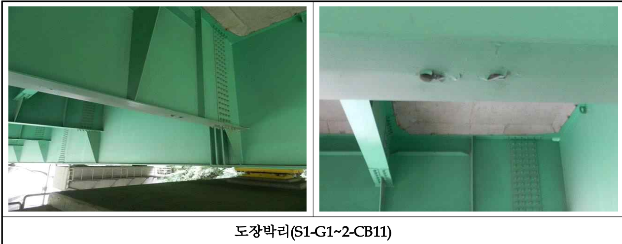
【사진 3.3.8】 가로보 및 세로보 손상현황(부산)
