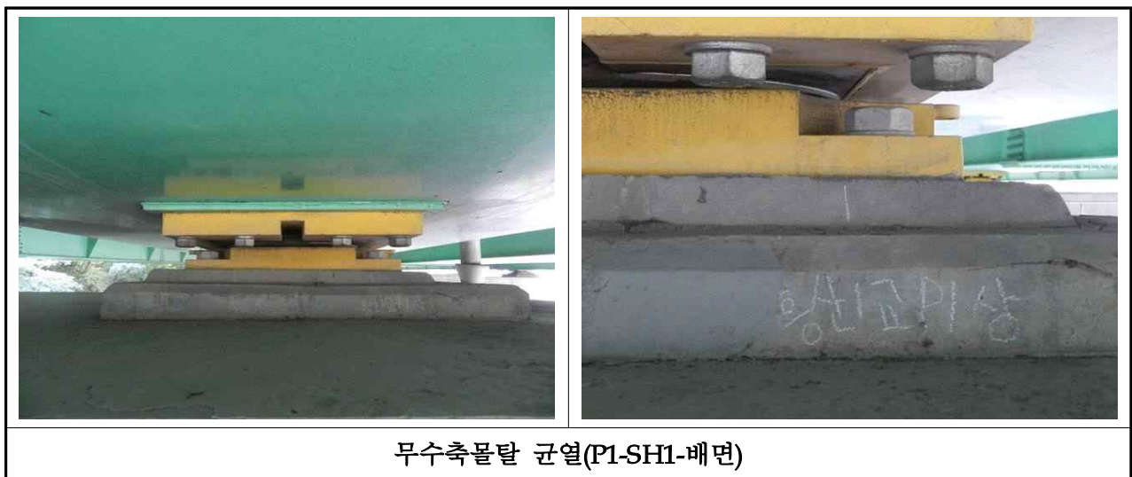
【사진 3.2.13】 교량받침 손상현황(대구)
