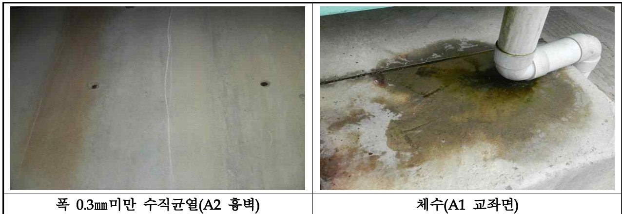
【사진 3.3.10】 교대 손상현황(부산)
